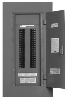
NQ 225A 42CCT MLO
