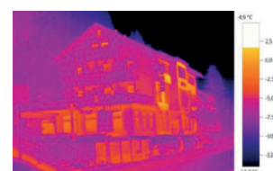
Imagen térmica con testo ScaleAssist
