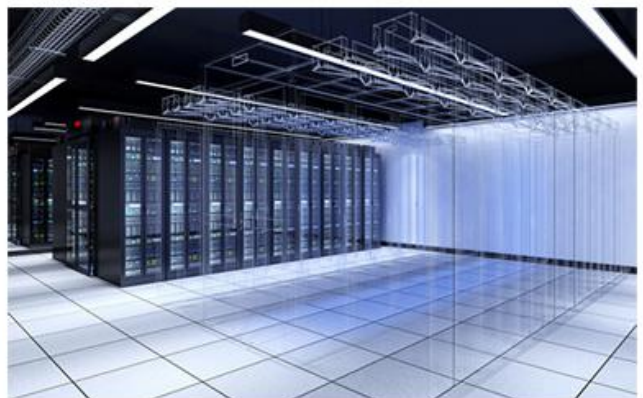
银行 证券 医院 大型工程机房数据中心
