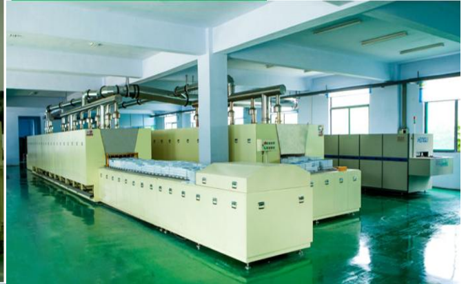
工厂车间图：排胶烧结车间
