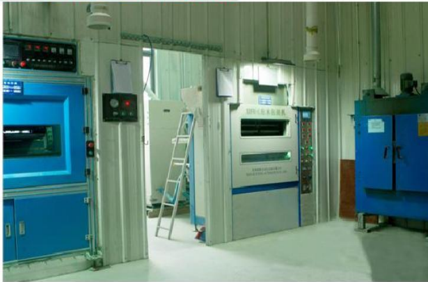
工厂车间图：环氧封装站
