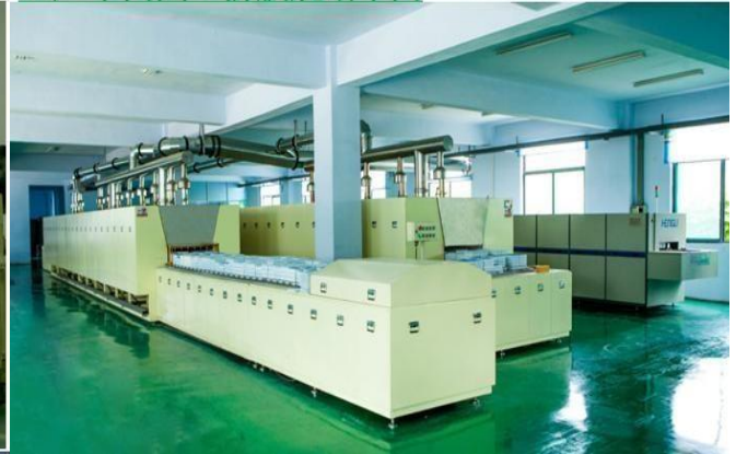
工厂车间图：排胶烧结车间
