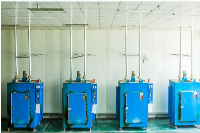
工厂车间图：箱式排胶车间
