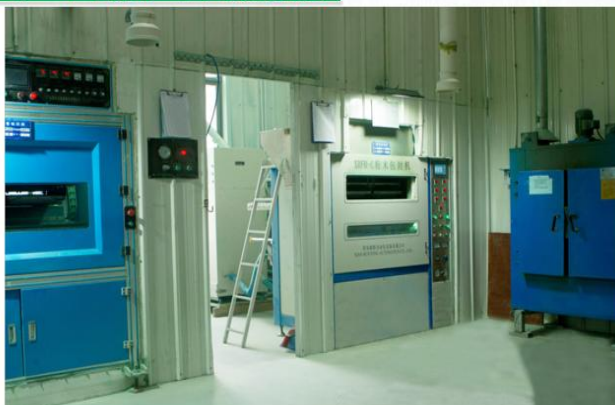
工厂车间图：环氧封装站
