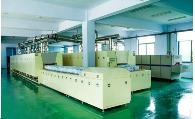
工厂车间图：排胶烧结车间
