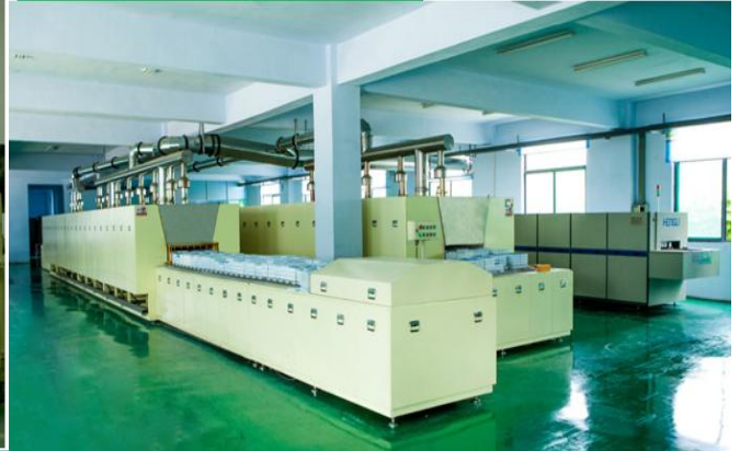
工厂车间图：排胶烧结车间
