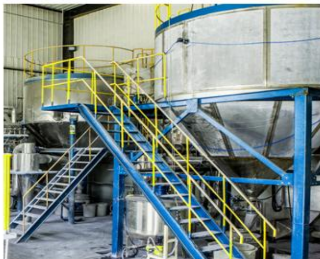
工厂车间场景图：造粒车间
