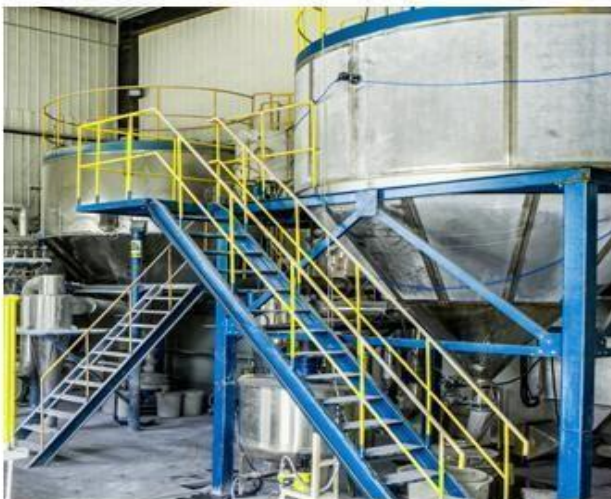
工厂车间场景图：造粒车间
