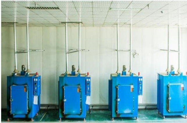
工厂车间图：箱式排胶车间
