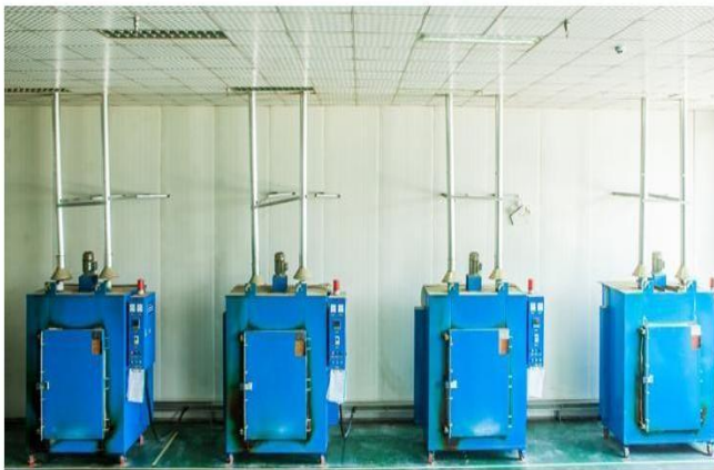
工厂车间图：箱式排胶车间
