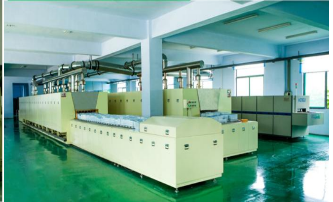
工厂车间图：排胶烧结车间
