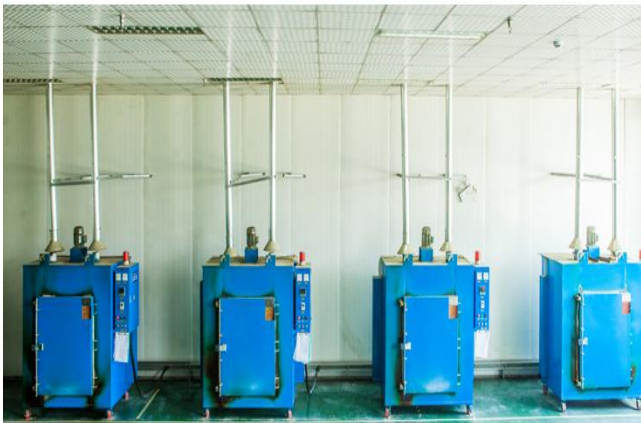
工厂车间图：箱式排胶车间
