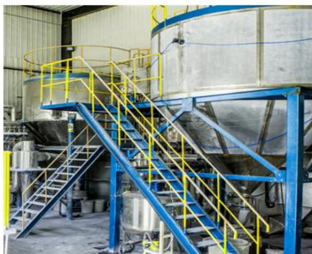
工厂车间场景图：造粒车间
