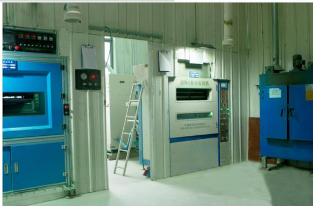
工厂车间图：环氧封装站
