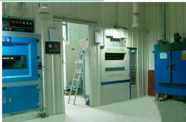
工厂车间图：环氧封装站
