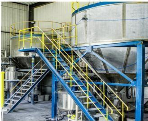
工厂车间场景图：造粒车间
