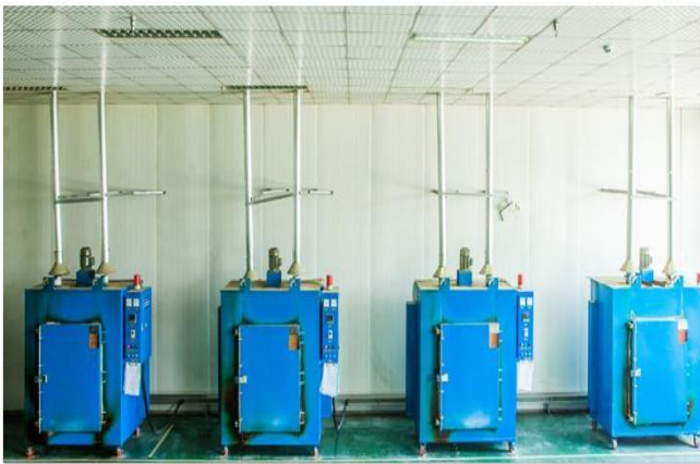
工厂车间图：箱式排胶车间
