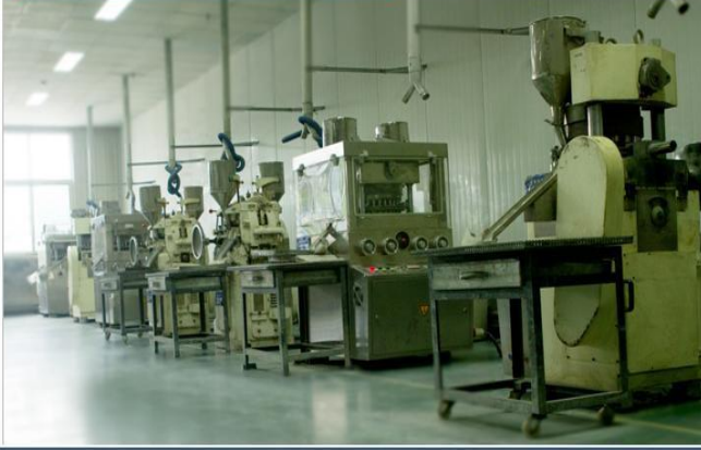
工厂车间场景图：压片车间
