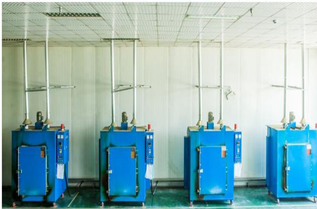
工厂车间图：箱式排胶车间
