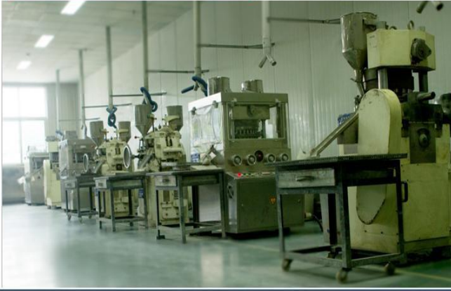
工厂车间场景图：压片车间
