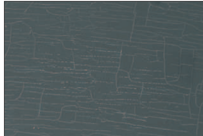
Das Gefüge ist durchgängig durch die UV-Strahlung geschädigt.
